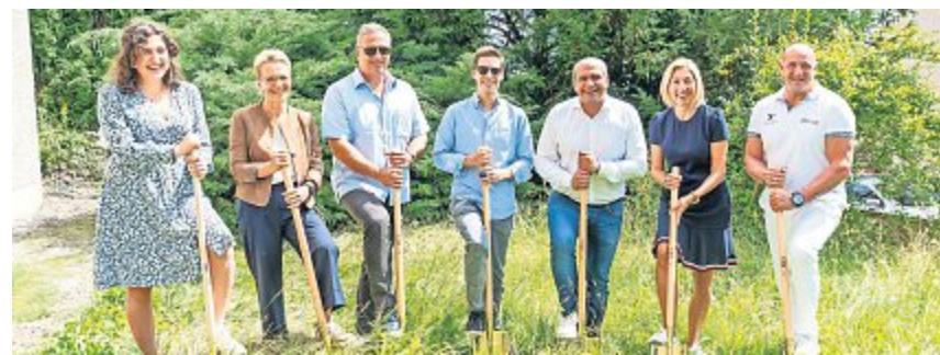
Freudige Gesichter der Bauherrschaft und dem Team der Projektentwicklerin beim Spatenstich auf dem Bauland des Belano Zuhause.
